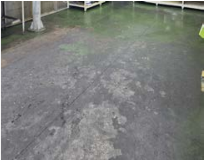
장비 수리 작업으로 인한 바닥 마모/손상 발생
