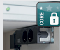
온도감지기가 개별 사물함의 화재를 감지하고 바로 LED경보등이나 경보음을 발생시킴
