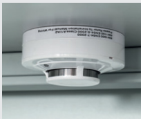
연기 감지기가 초기화재를 감지해 빌딩 제어시스템에 경보를 전달함
